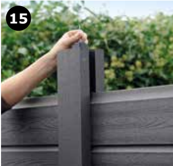
15 Vent med at sætte den sidste profil i stolperne, da der først skal sættes K11 Topklods i toppen af stolpen.
